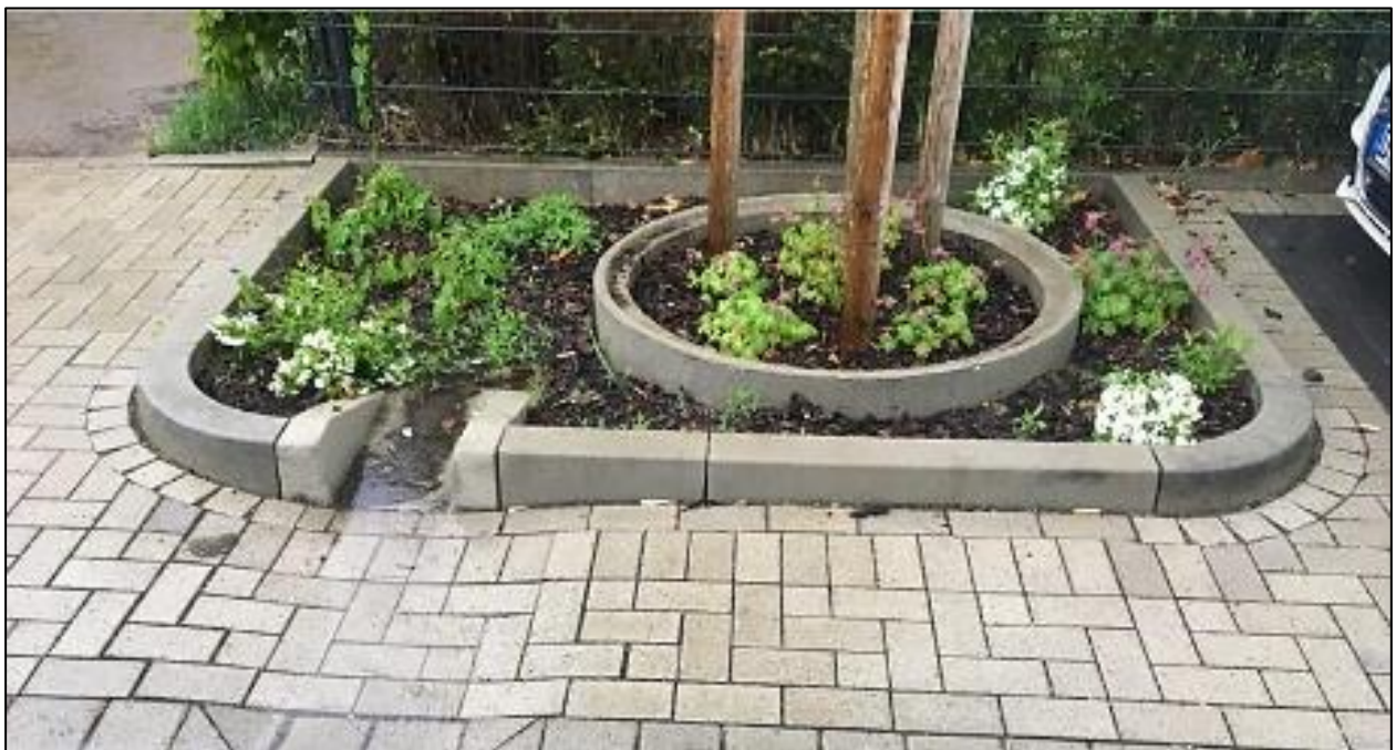
Abb. 60: Beispiel für einen geleiteten Zugang von Oberflächenabflüssen in eine Baumscheibe. Eine flache Mulde leitet das Wasser von den Verkehrsflächen zum Baum. (Quelle: HLNUG, 2023)
